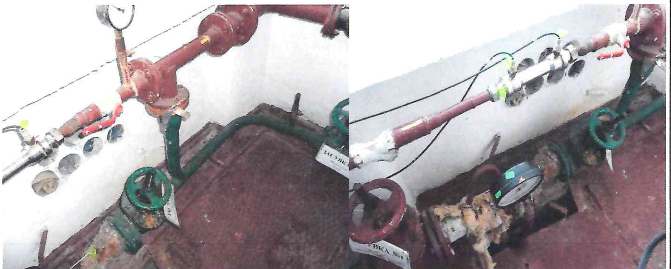
Рисунок 5.1.1. Трубопроводи опалення, встановлений тепловий лічильник
